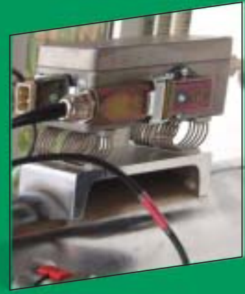
Anti-vibration sur pompe
